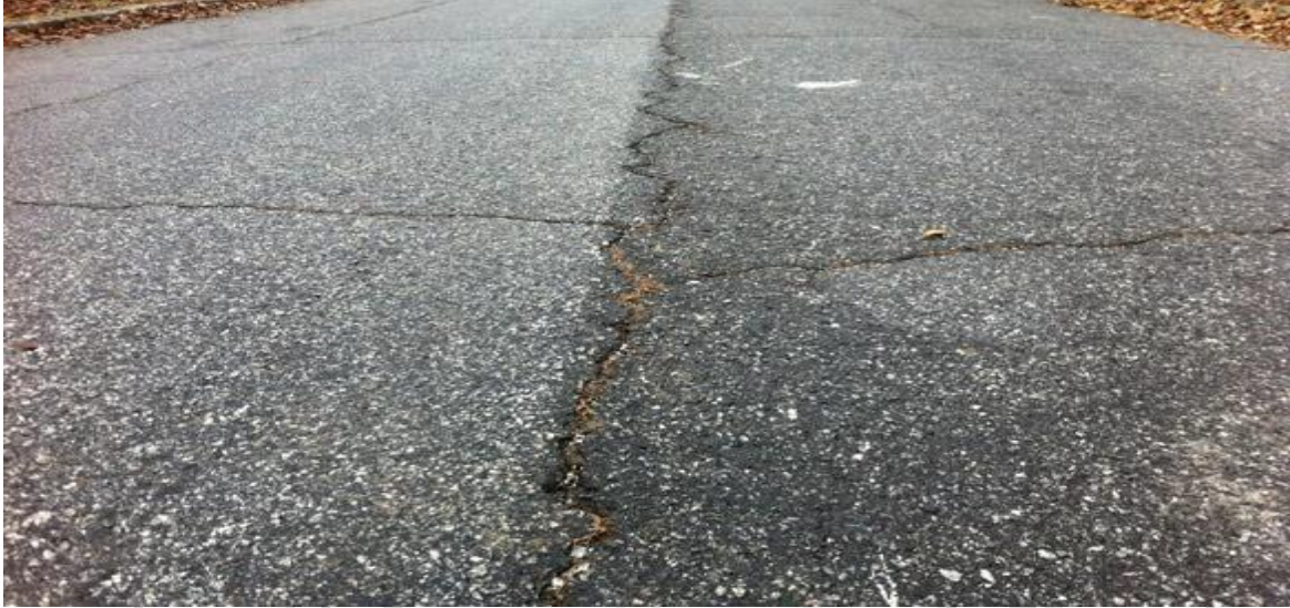
Longitudinal (Linear) Cracking
