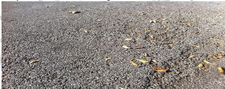
Fig. Raveling (very porous asphalt)
