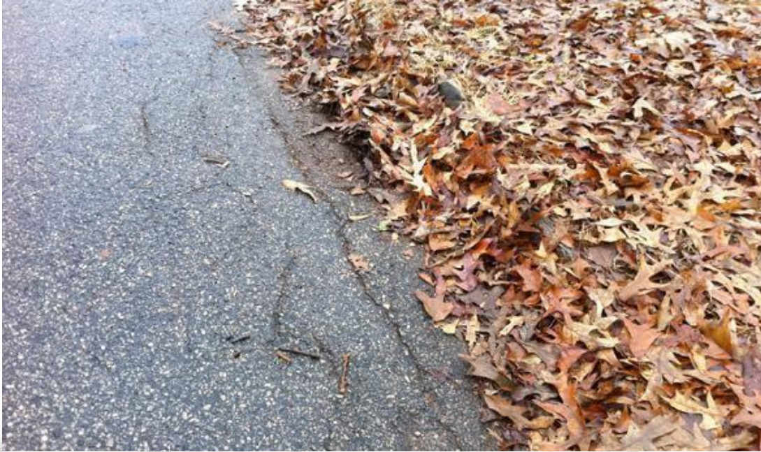
Fig. Edge Cracks
