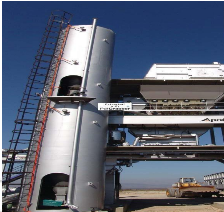
Fig. Mineral filler unit
